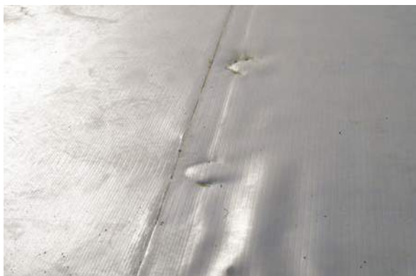
Рис. 3.5.7 Дефект сварного шва
