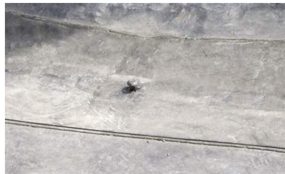
Рис. 3.5.10 Повреждение мембраны шляпкой самореза при применении тарельчатого металлического держателя по минераловатному утеплителю
