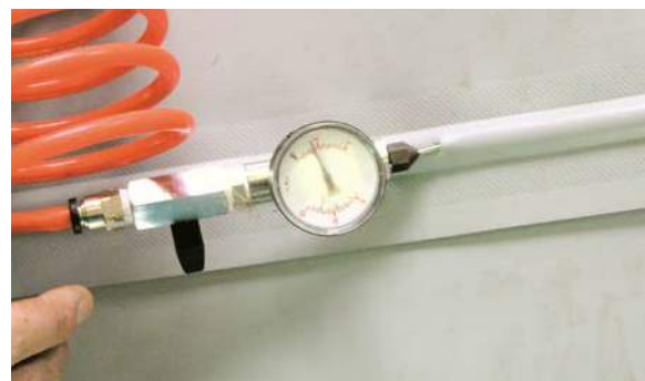
Рис. 5.2.13 Проверка герметичности с использованием сквозного канала
