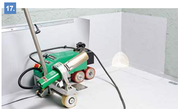
17. Закруглите все углы. Приварите полосу к основному кровельному ковру при помощи автоматического оборудования.
